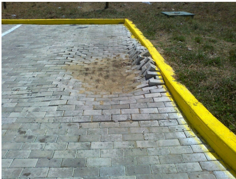
Figura 1 Fallo de un pavimento de adocreto
