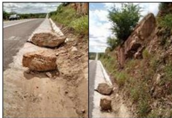
Figura 9. Trechos apresentando quedas de blocos (BR- 304). Fonte: autores (2017).
