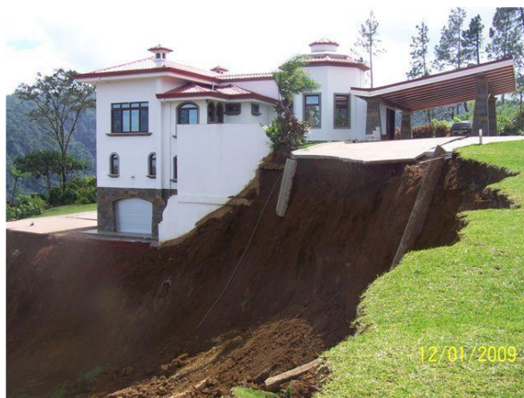
Figura 35 Falla talud durante sismo
