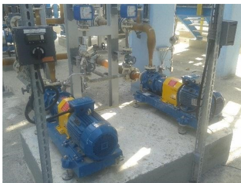
Fig 4 Bombas del sistema
