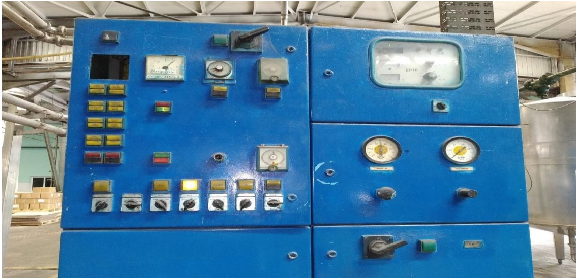
Figura 2. Panel eléctrico de VNPX 417 antes de la modernización.
