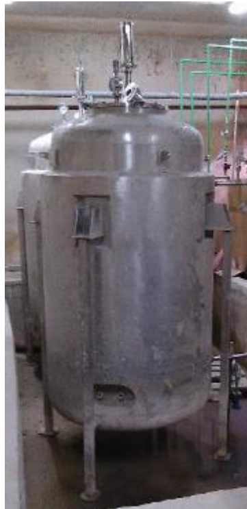
Figura 3. Tanque enchaquetado para el almacenamiento y tratamiento de los residuales.
