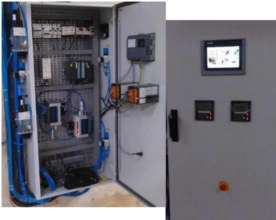
Figura 8. Panel de control con elementos eléctricos, neumáticos y de control automático.
