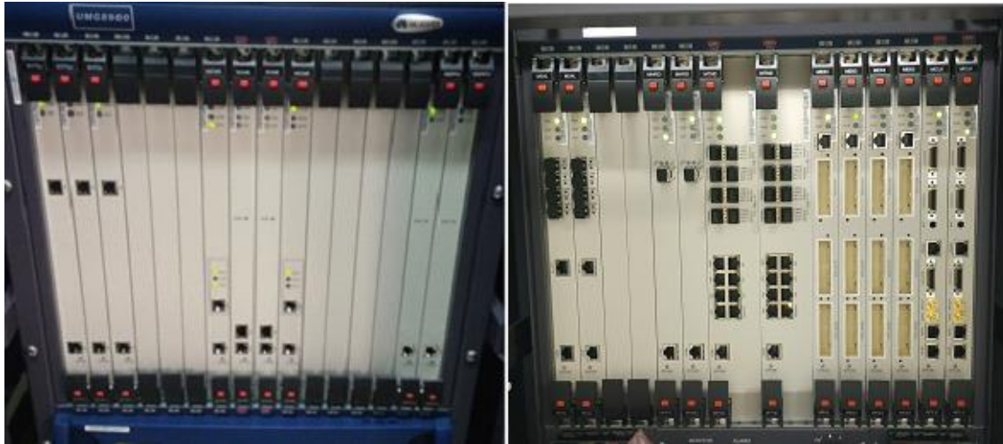
Figura 3. Vista frontal (izquierda) y trasera (derecha) del subrack Media Gateway UMG8900.
