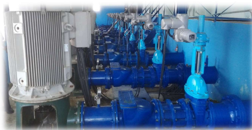
Fig. # 4 Estación de Bombeo de gran envergadura.
