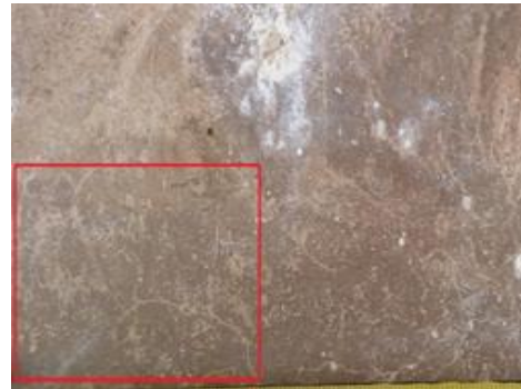
Figura 5 Fisuras en la muestra LC65
