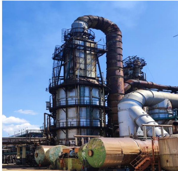
Figura 1. Horno tubular F 101 de la Refinería "Hnos Díaz".
